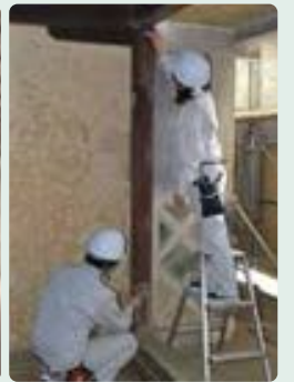
はそんちようき 破損調査
